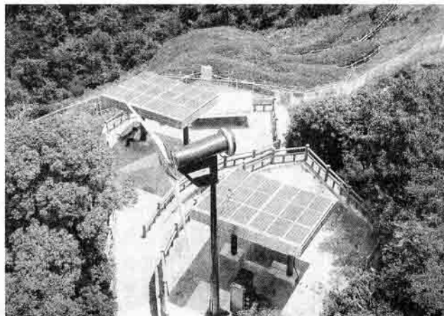
ワット神戸が施工した太陽光発電設備と風力発電。神戸市のシンボルマークをライトアップする(神戸市中央区)
